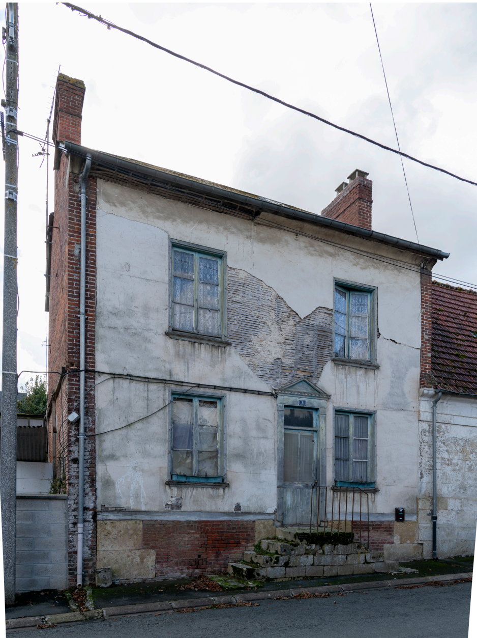
Logis en pans de bois et torchis, solins en pierre dure, n°4 de la rue d'En-Bas, vue depuis le nord.
