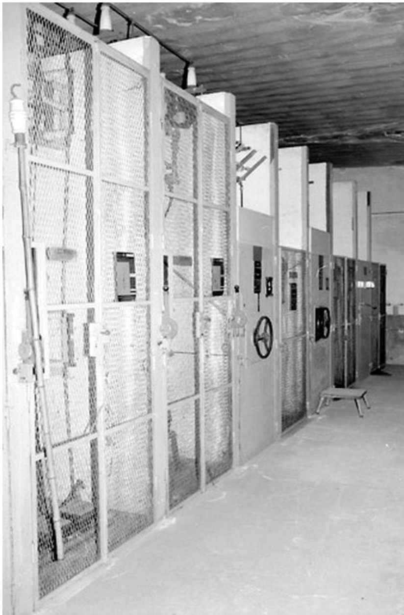
Transformateur : vue intérieure.
