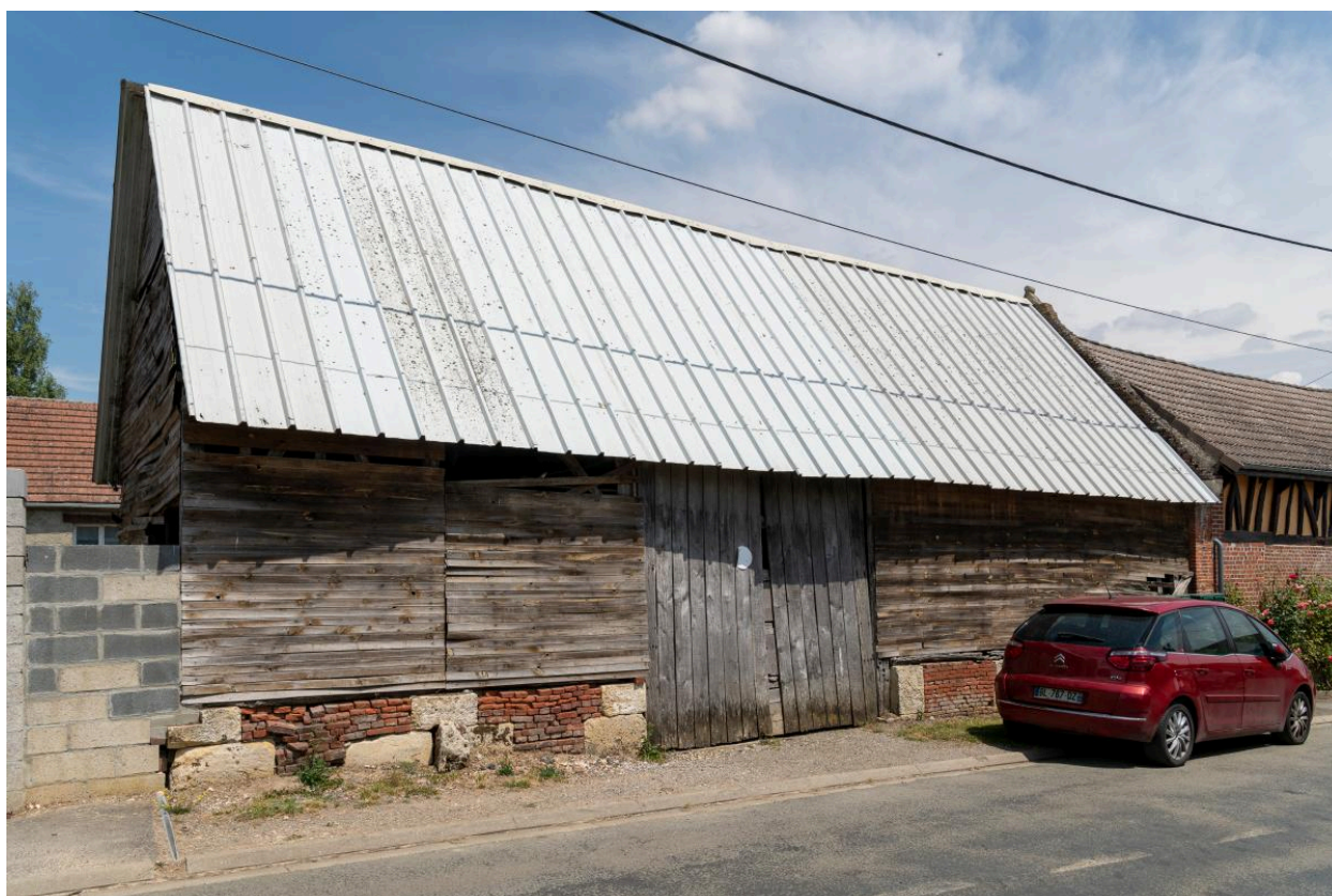
Ancienne grange sur rue avec entrée charretière, n°10 rue d'En Haut, vue depuis le sud-ouest.
