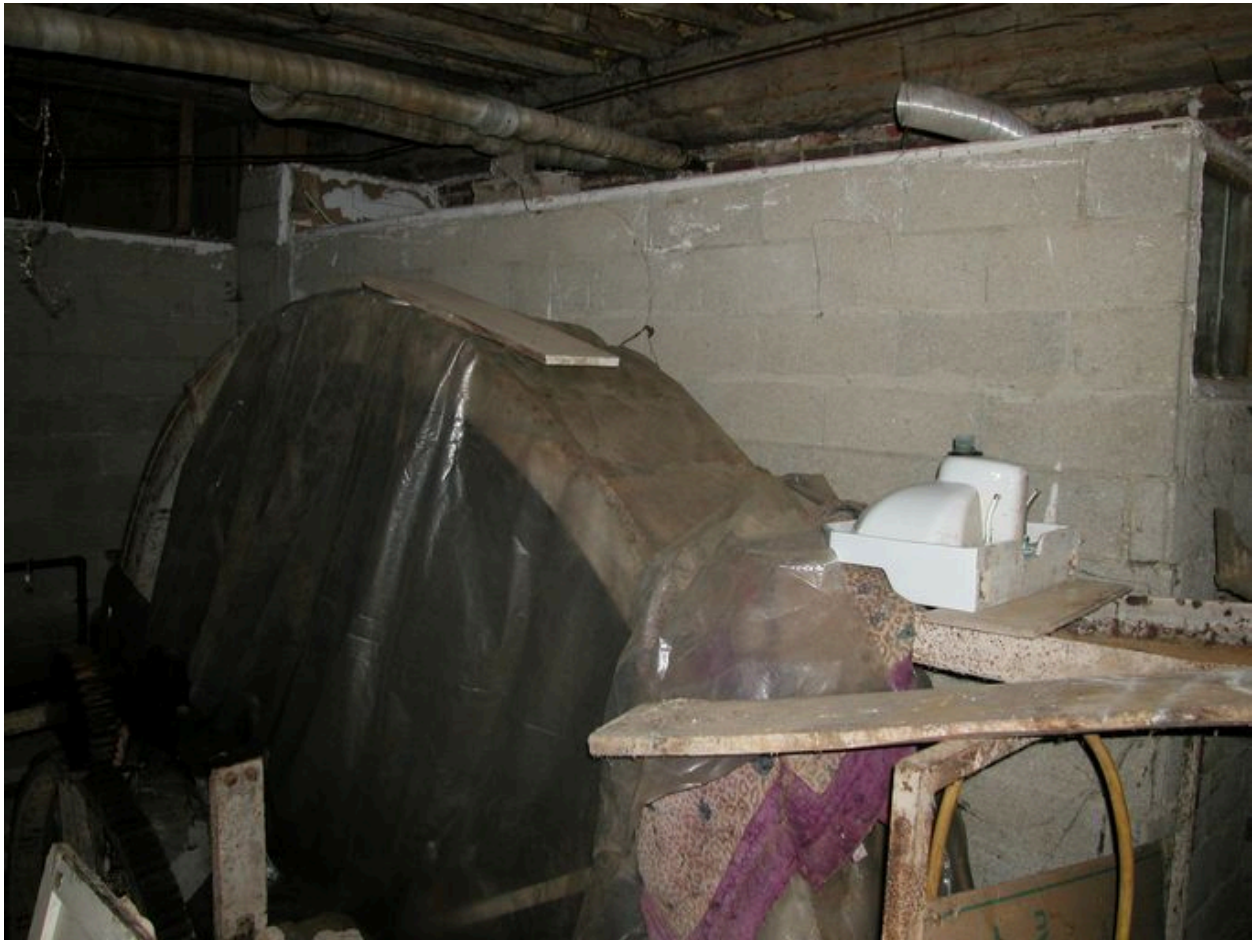
Vue de la roue hydraulique par dessus (sous bâche).
