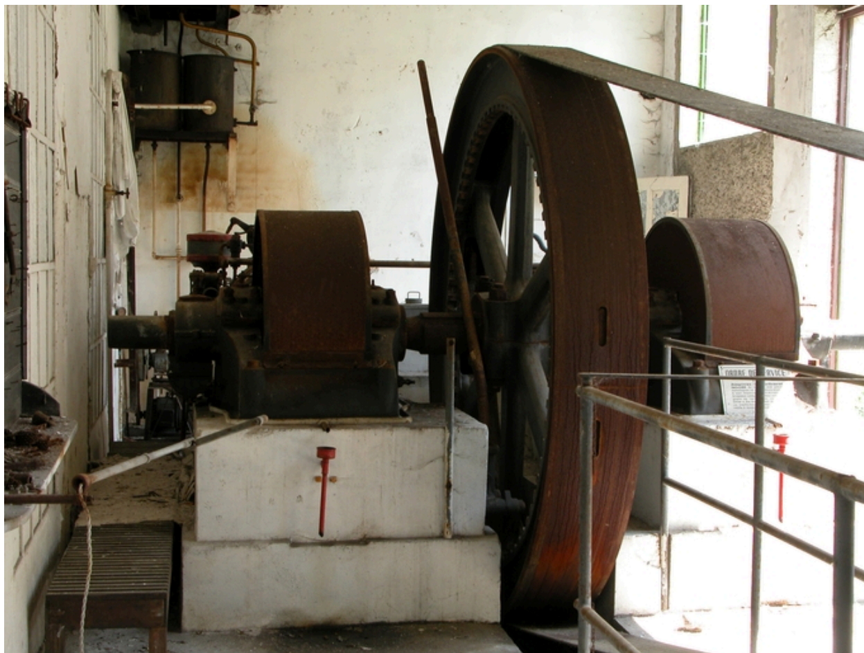
Les deux moteurs et le volant de la machine à gaz.
