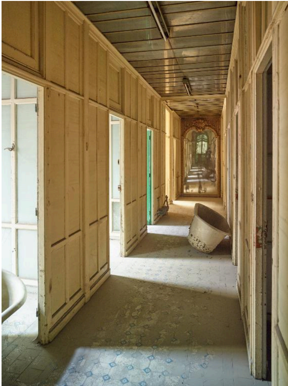
Aile nord, premier étage. Bains de baignoires de luxe pour hommes. Vue, du couloir distribuant les cabines, vers le nord.
