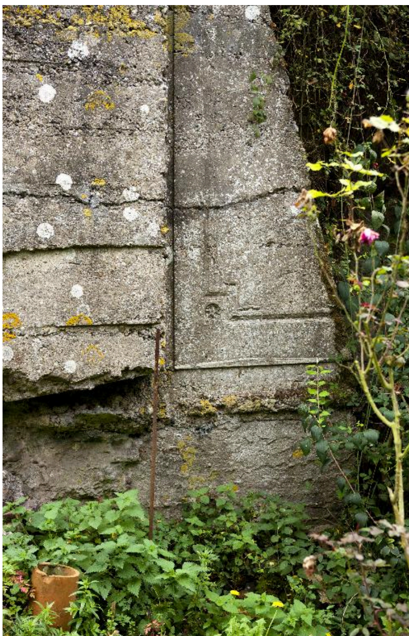
Détail du contrefort est. Empreintes d'une porte
