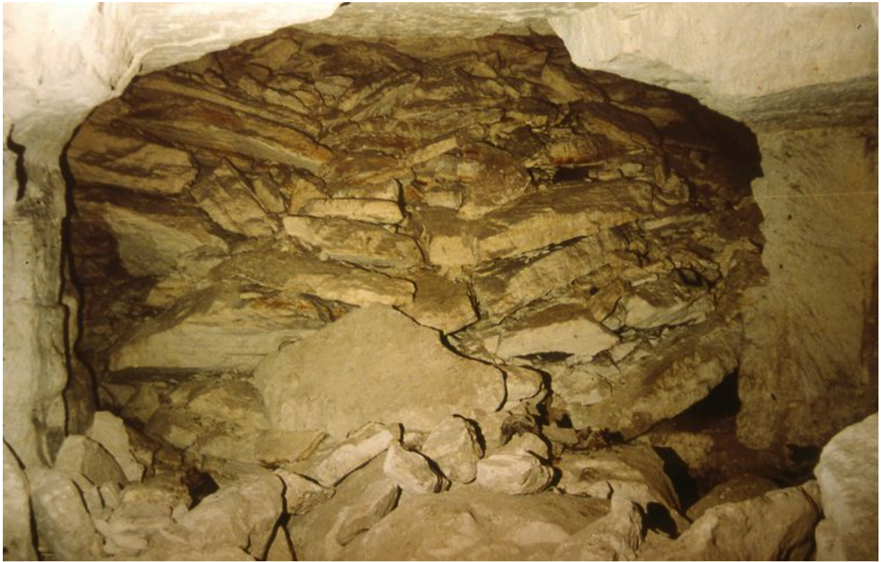
Vue d'une galerie obstruée.
