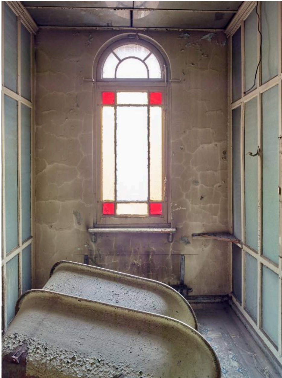
Aile nord, premier étage. Bains de baignoires de luxe pour hommes, deuxième cabine à gauche.
