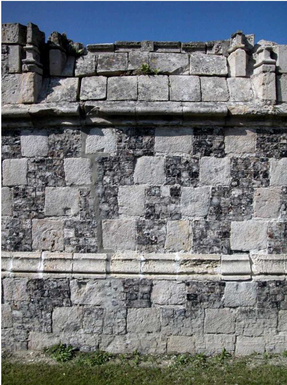
Détail de l'appareil mixte (craie, silex) de l'ancienne église paroissiale en ruines.
