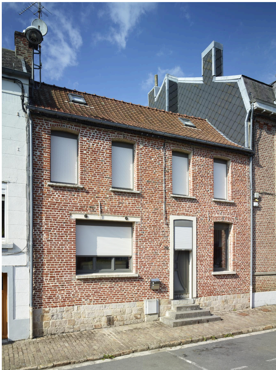
Maison du XVIIIe siècle : reprise des baies à la fin du XIXe siècle visible sur le linteau en fer en #, porte précédée d'un degré - 34, rue Baillon.
