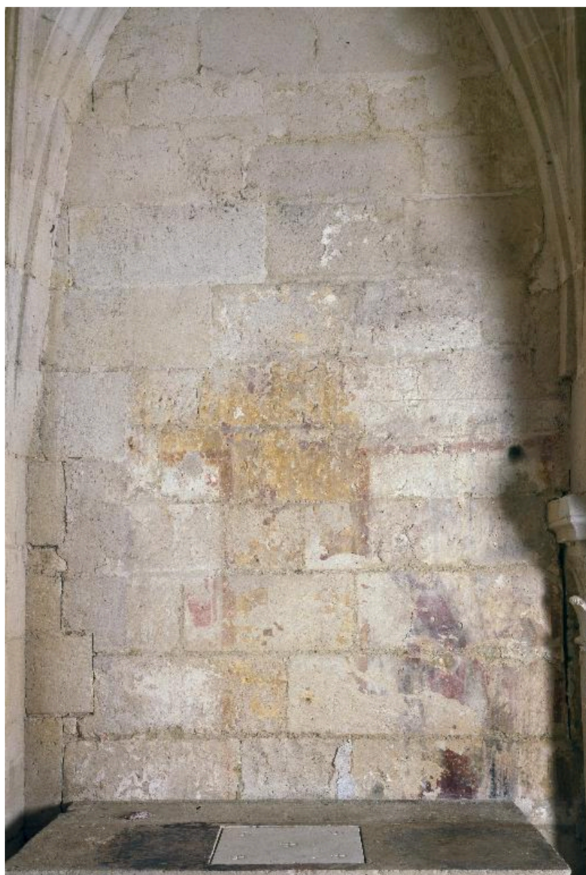
Vue des traces de peinture murale qui subsistent sur le mur oriental du collatéral nord de la nef.
