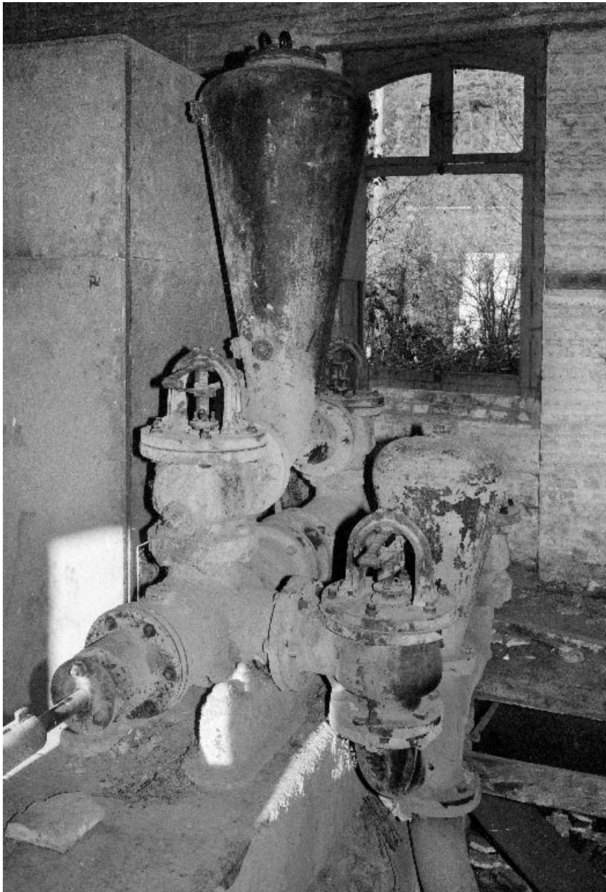
Salle des machines, rue du 19e BCP. Pompe à eau.
