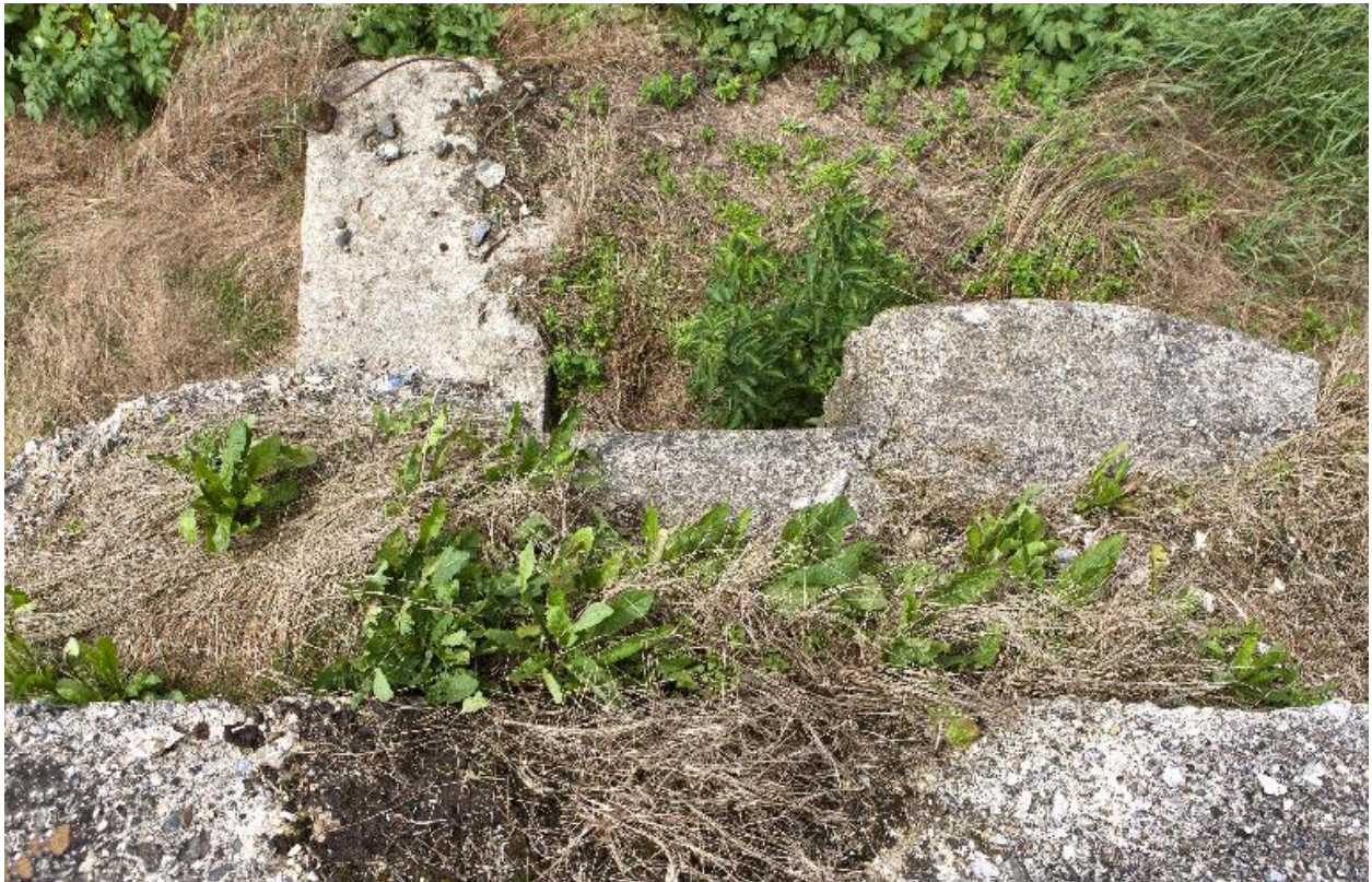
Vue de dessus du porche pare-souffle
