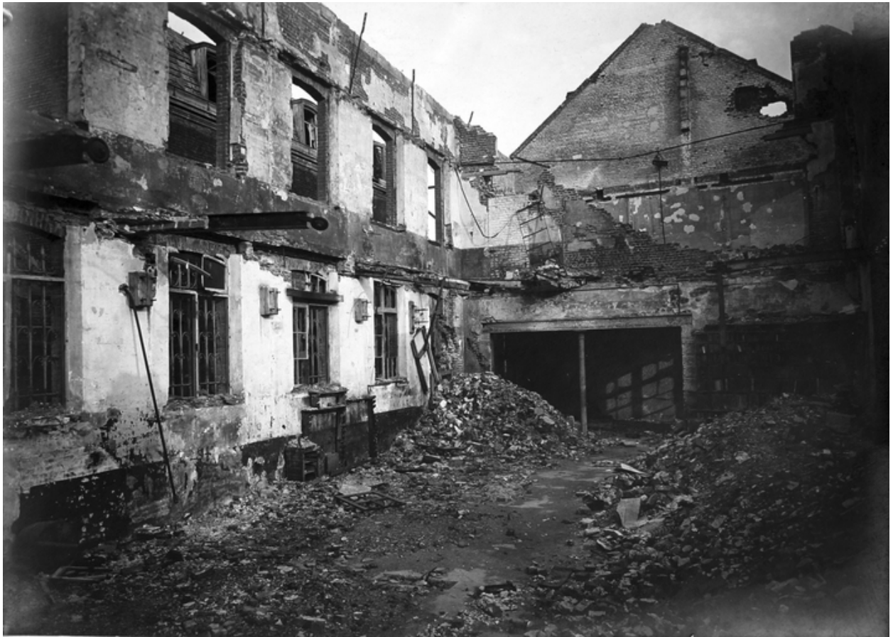
Ruines des ateliers de l'imprimerie Dupré & Thellier, place de l'Hôtel de Ville (AD Aisne).
