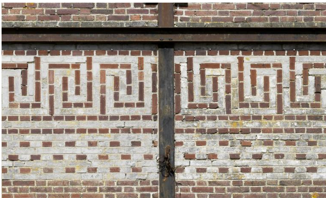
Détail de la frise décorative qui orne le pignon de l'atelier de fabrication.
