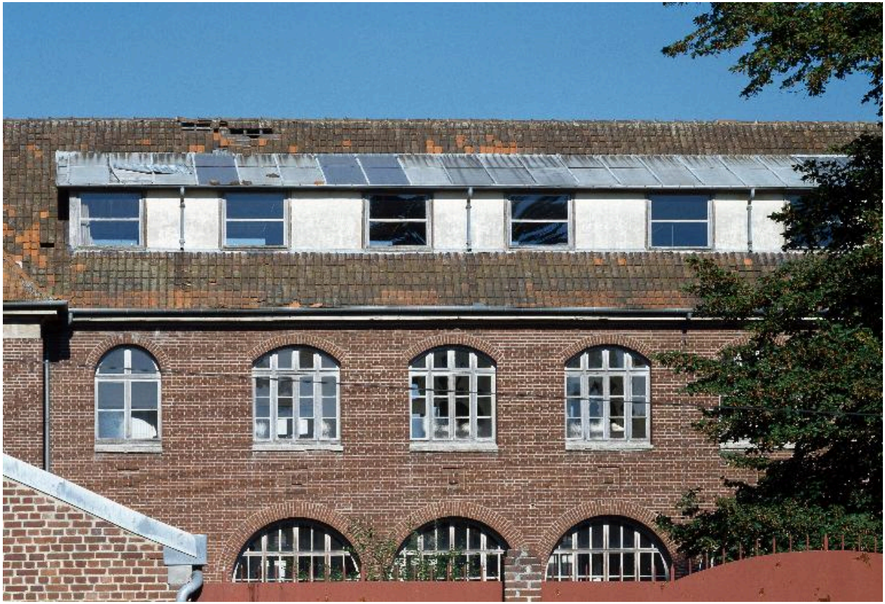
Détail de la partie supérieure de la façade depuis la rue Victor-Hugo.
