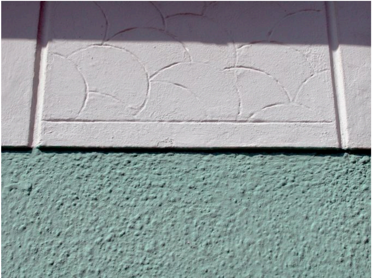
Détail du crépi et de la partie supérieure de l'élévation, avec motifs Art déco.
