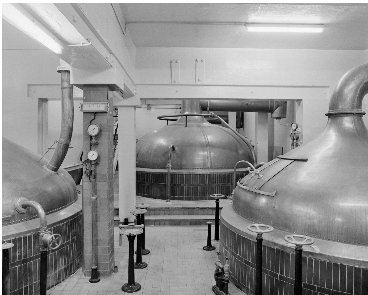
Salle de brassage, vue générale.
