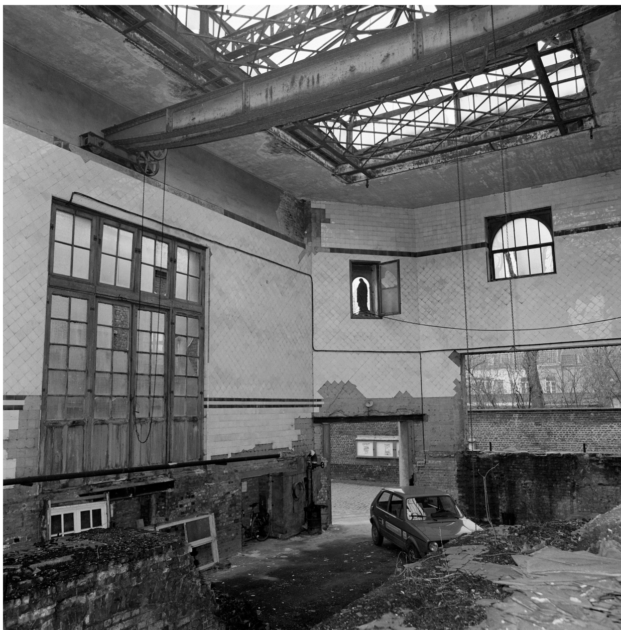
Salle des machines. Vue générale.
