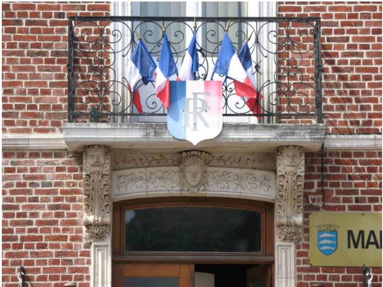
Détail du balcon de la façade principale et de ses consoles sculptées.
