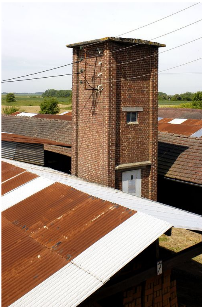
Le transformateur électrique entre les halles de séchage.
