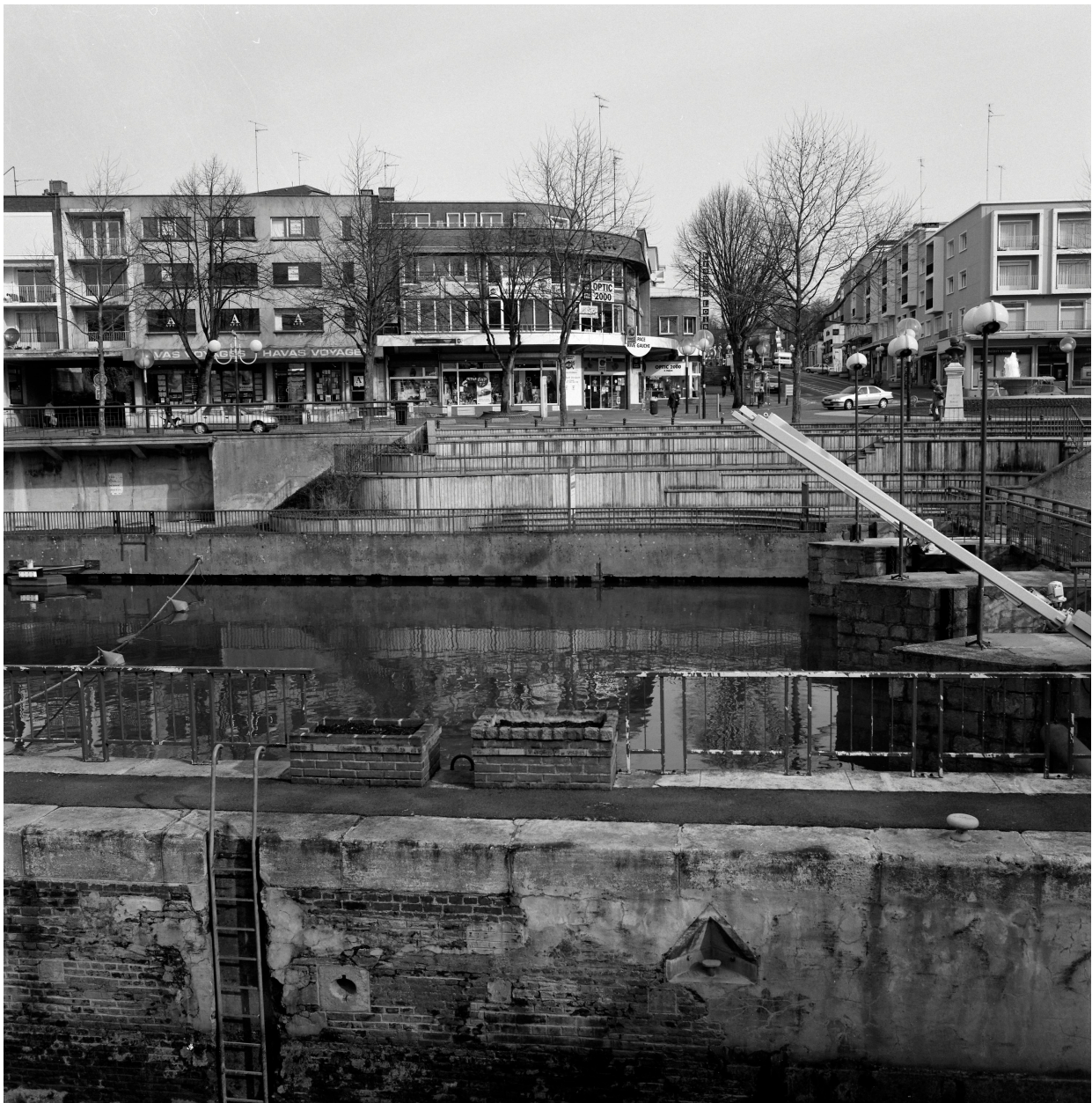
Vue générale de l'aménagement du quai de la Sambre à l'angle du boulevard.
