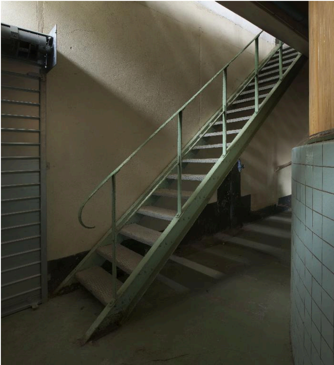
Escalier métallique desservant la salle de brassage et de filtration.
