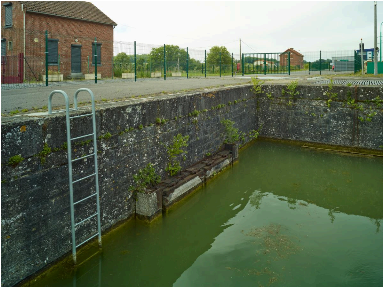
Le bassin de tranquillisation avec échelle de secours. Au second plan la maison de service (amont).
