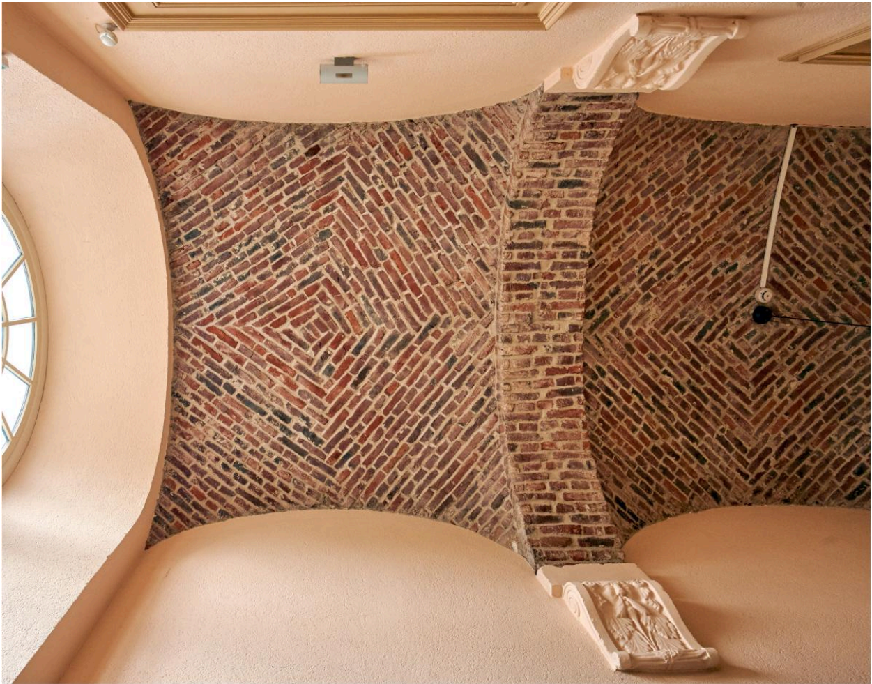
Détail du voûtement du couloir longeant la bibliothèque et menant à l'ancien cloître (actuel CDI du lycée).
