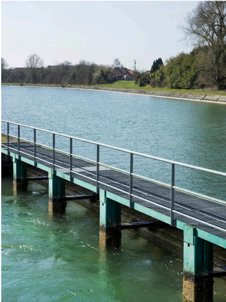
Estacade de guidage, passerelle métallique du bassin de tranquillisation à l'aval de l'écluse.
