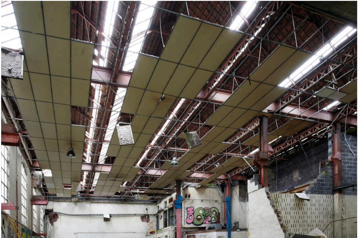
Charpente de la salle des machine depuis l'entrée. À droite, la cabine de commande.
