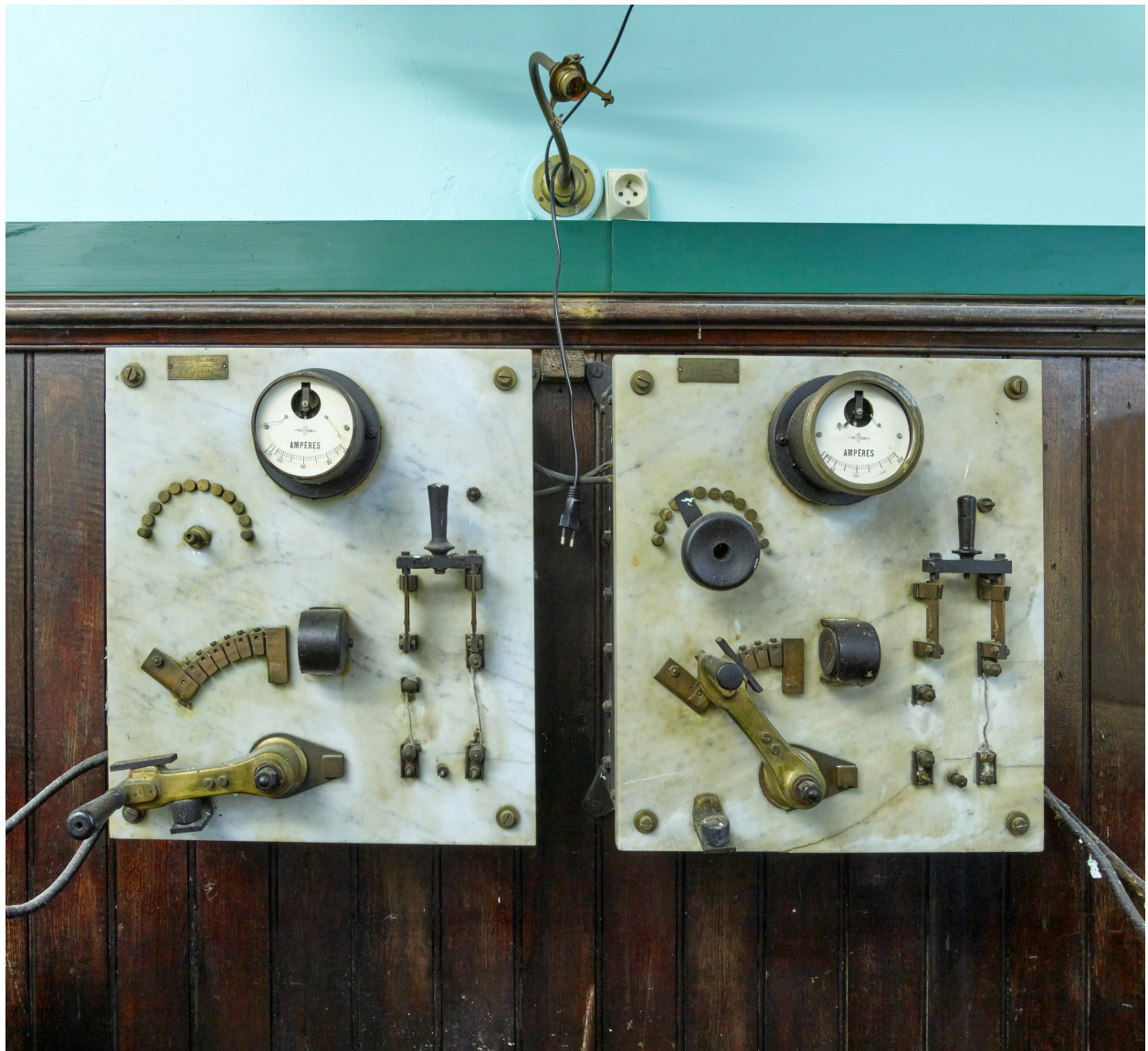
Intérieur, tableau de contrôle de la pompe à eau.
