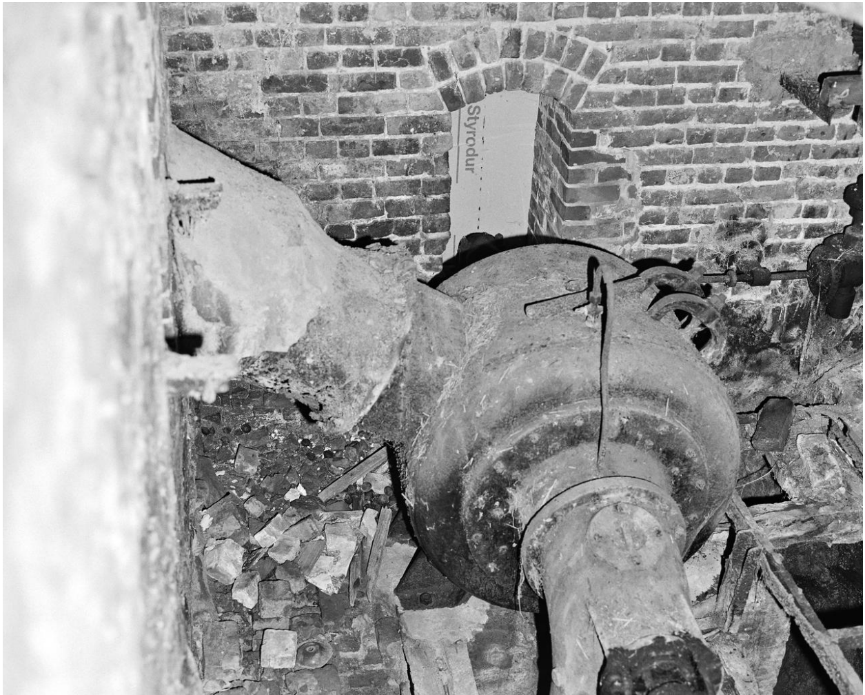
Turbine hydraulique (état de 1993).
