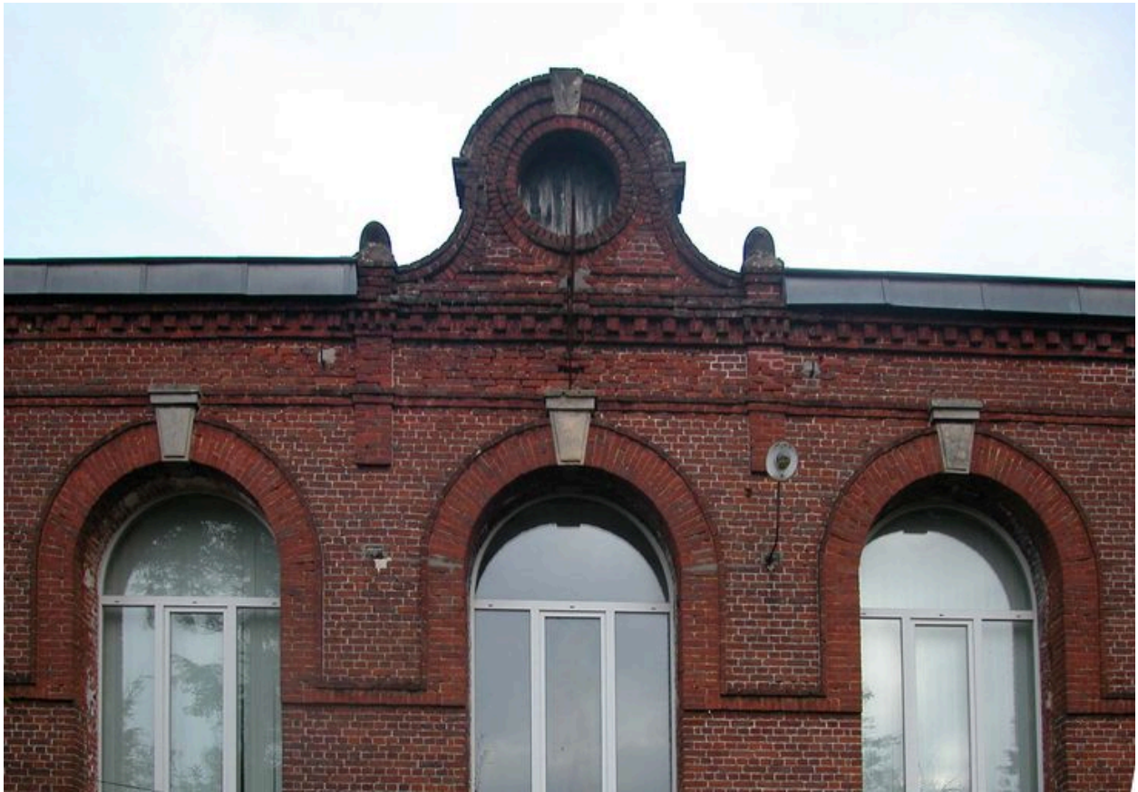
Détail de la partie centrale de la façade sur cour de l'atelier principal.
