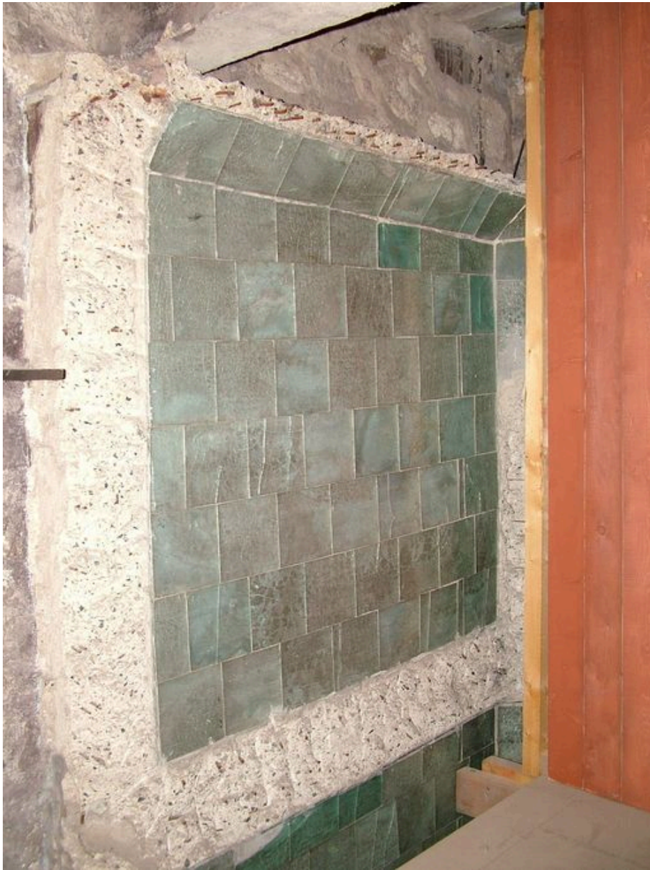
Vue des cuves de stockages détruites.
