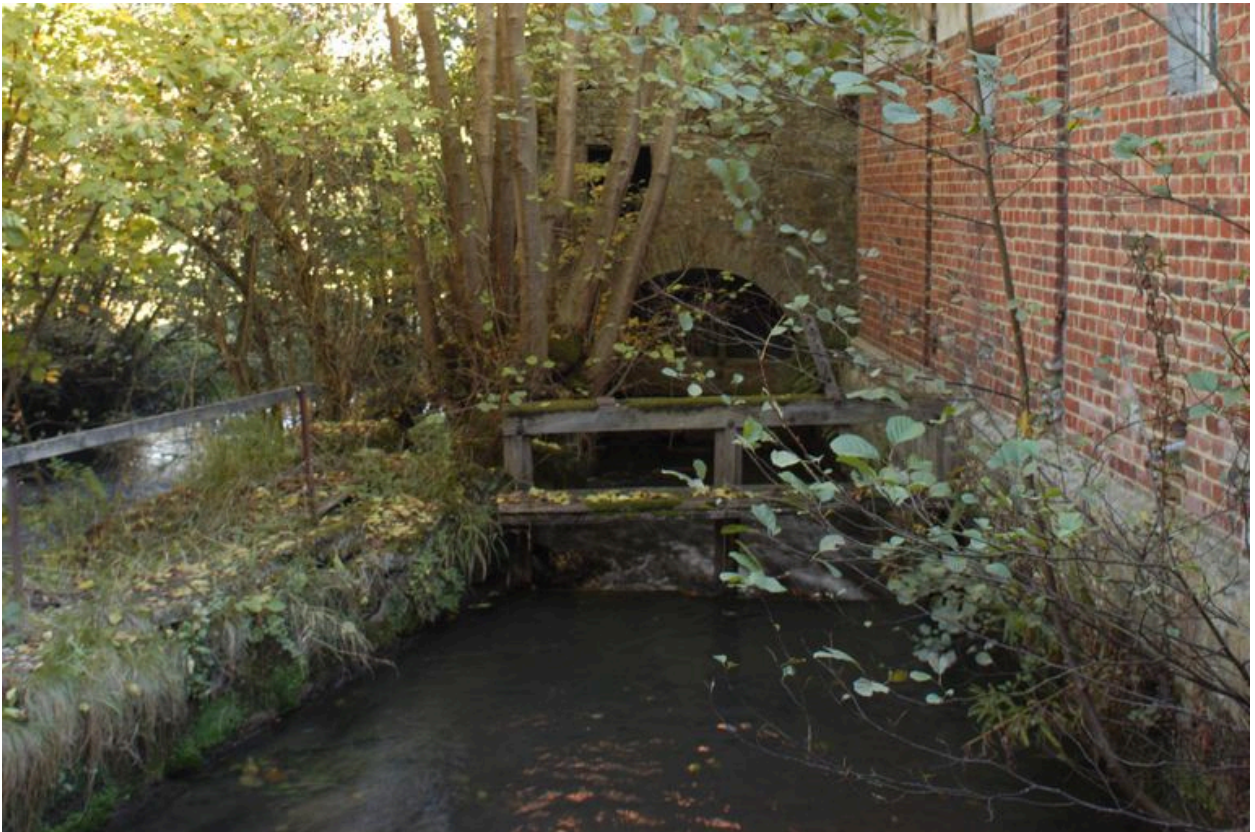
Le canal d'amenée, le vannage et la coulerie sous cage maçonnée, face ouest.
