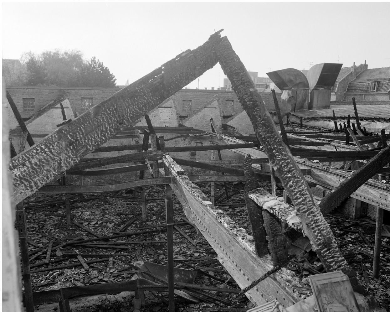
Atelier de fabrication après incendie, couverture.
