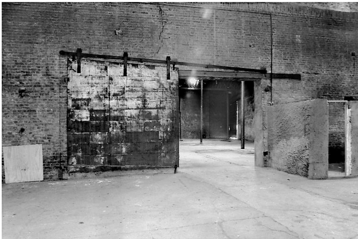
Entrepôt industriel. Vue intérieure. Porte inifugée.
