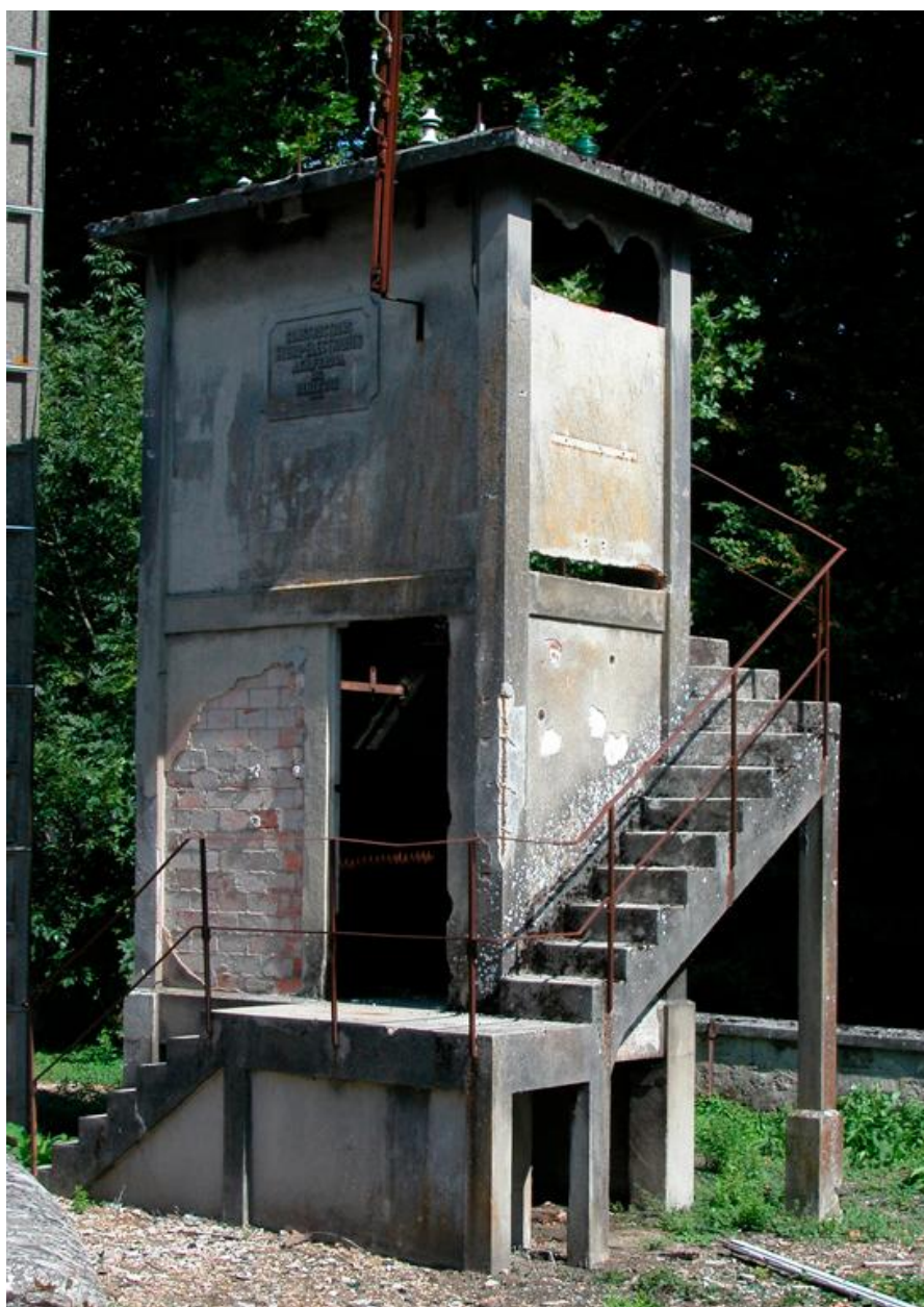
Vue du transformateur.
