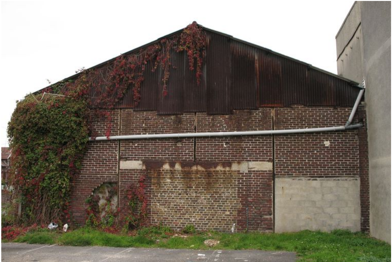
Etat du mur pignon sud-ouest en brique.
