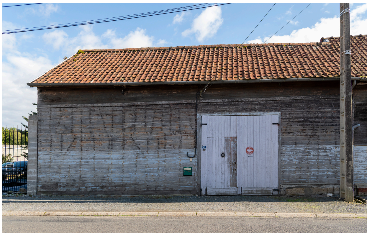
Grange essentée de planches, n°19 de la rue Fernand-Moreau, vue depuis le nord.
