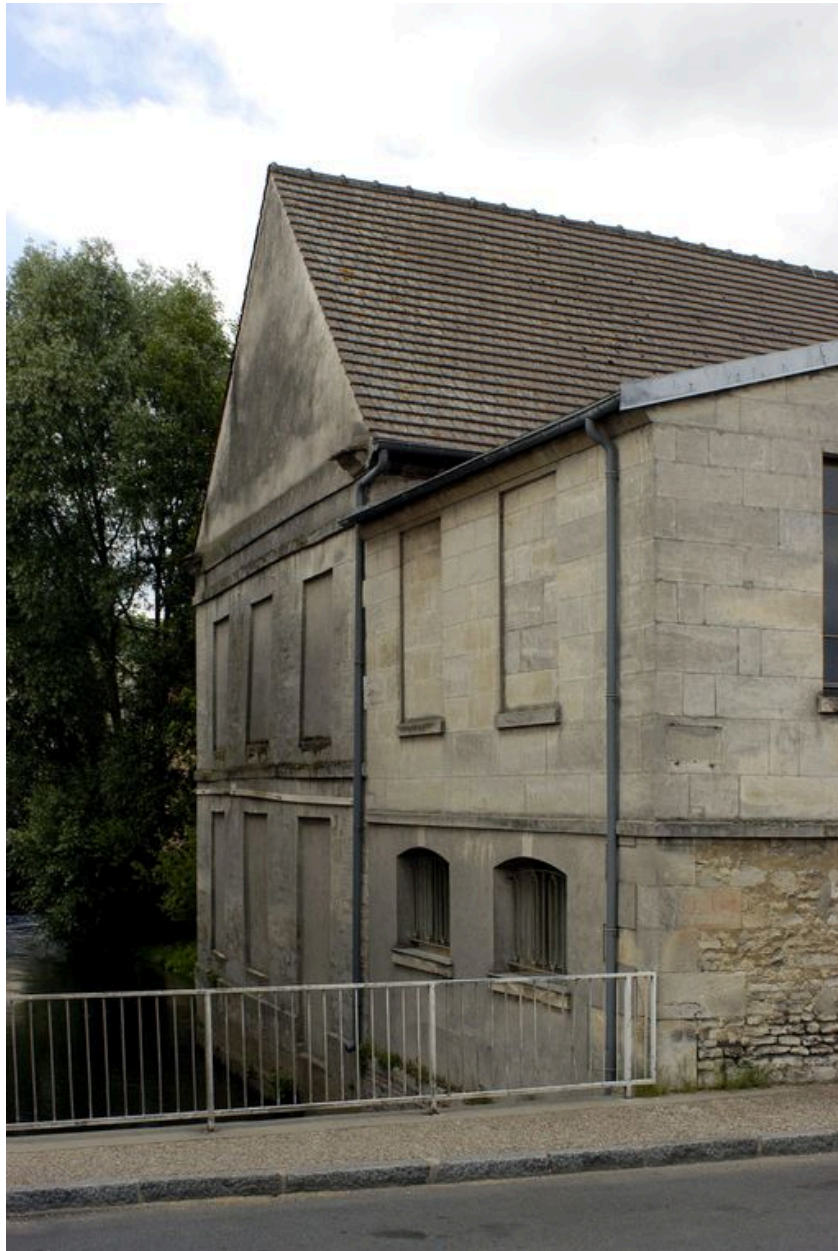
Le pignon sur la rivière de la filature, vue depuis le pont.
