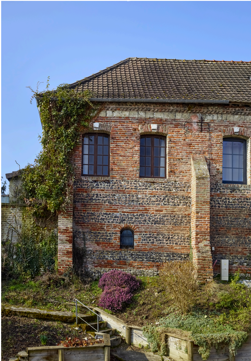
Détail de l'élévation du bâtiment sur rue de l'ancienne ferme, depuis l'est.
