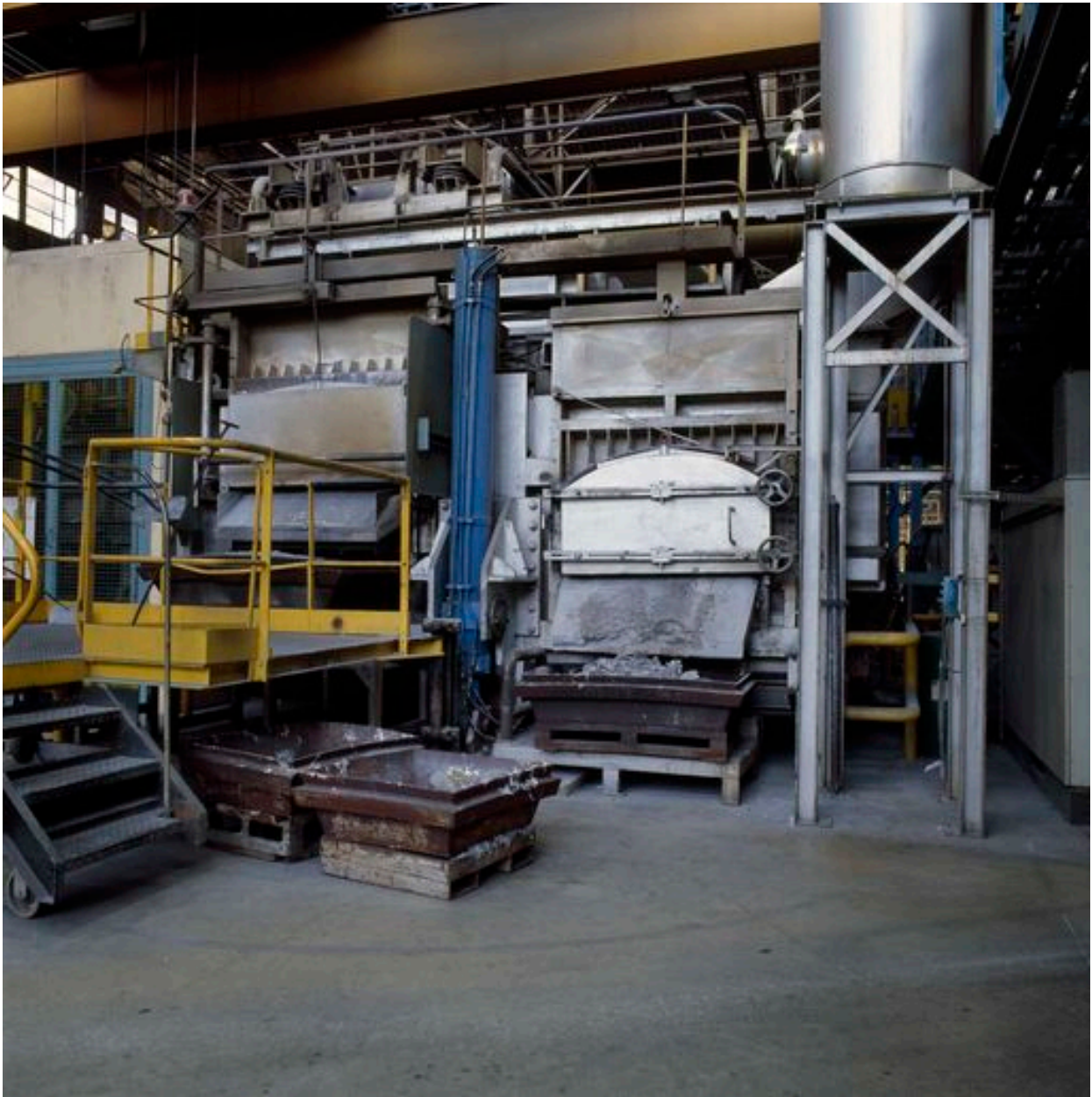
Détail d'un four.
