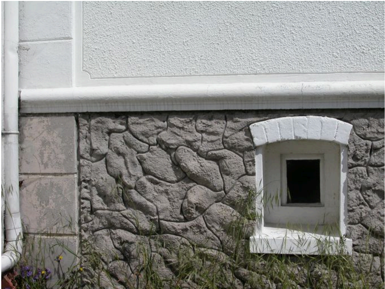
Enduit imitant des moellons de pierre, base du mur des maisons Les Mouettes et Les Tilleuls, avenue Carnot (1988 BB 34, 35).
