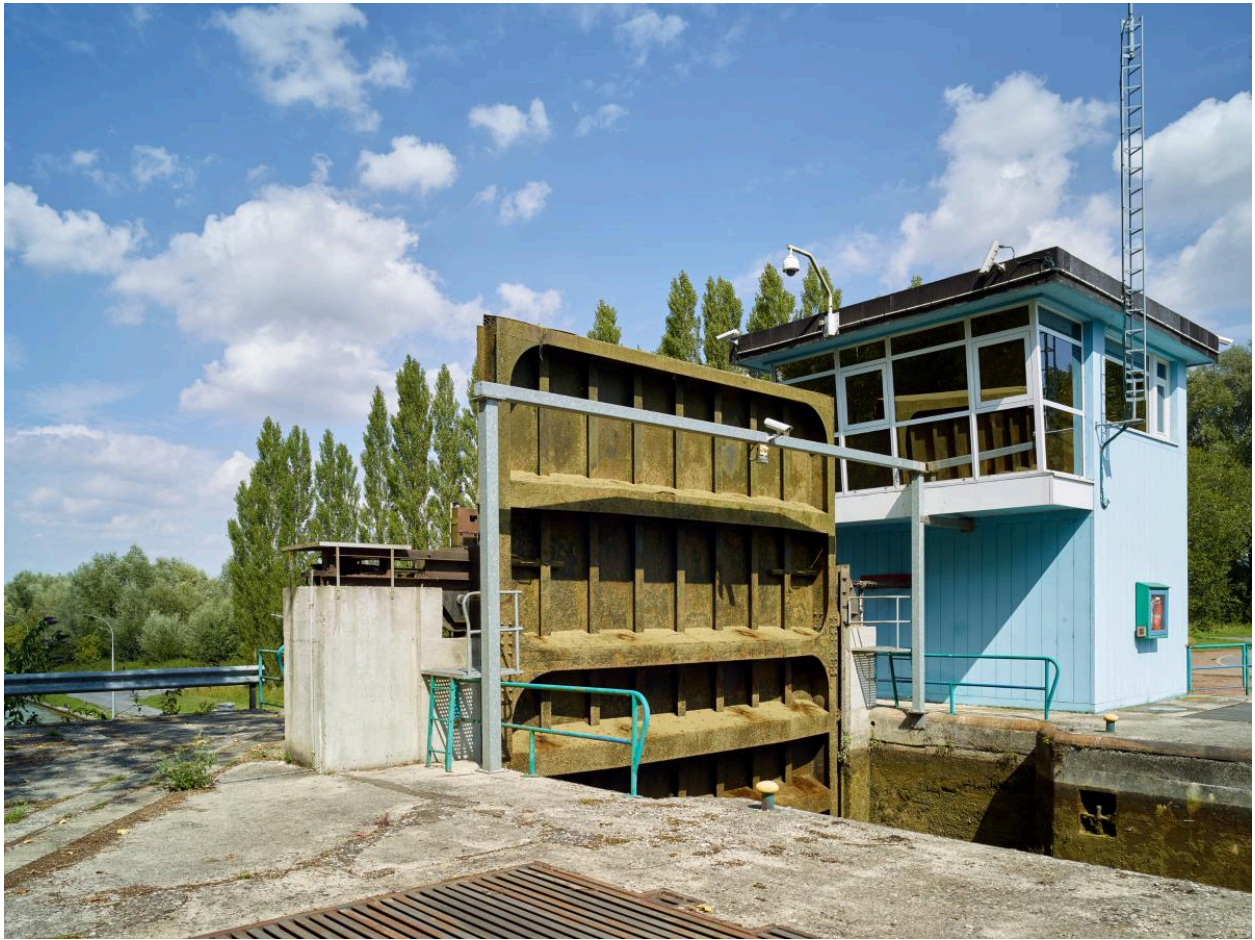
Vue depuis l'aval. Poste de commande et porte levante.
