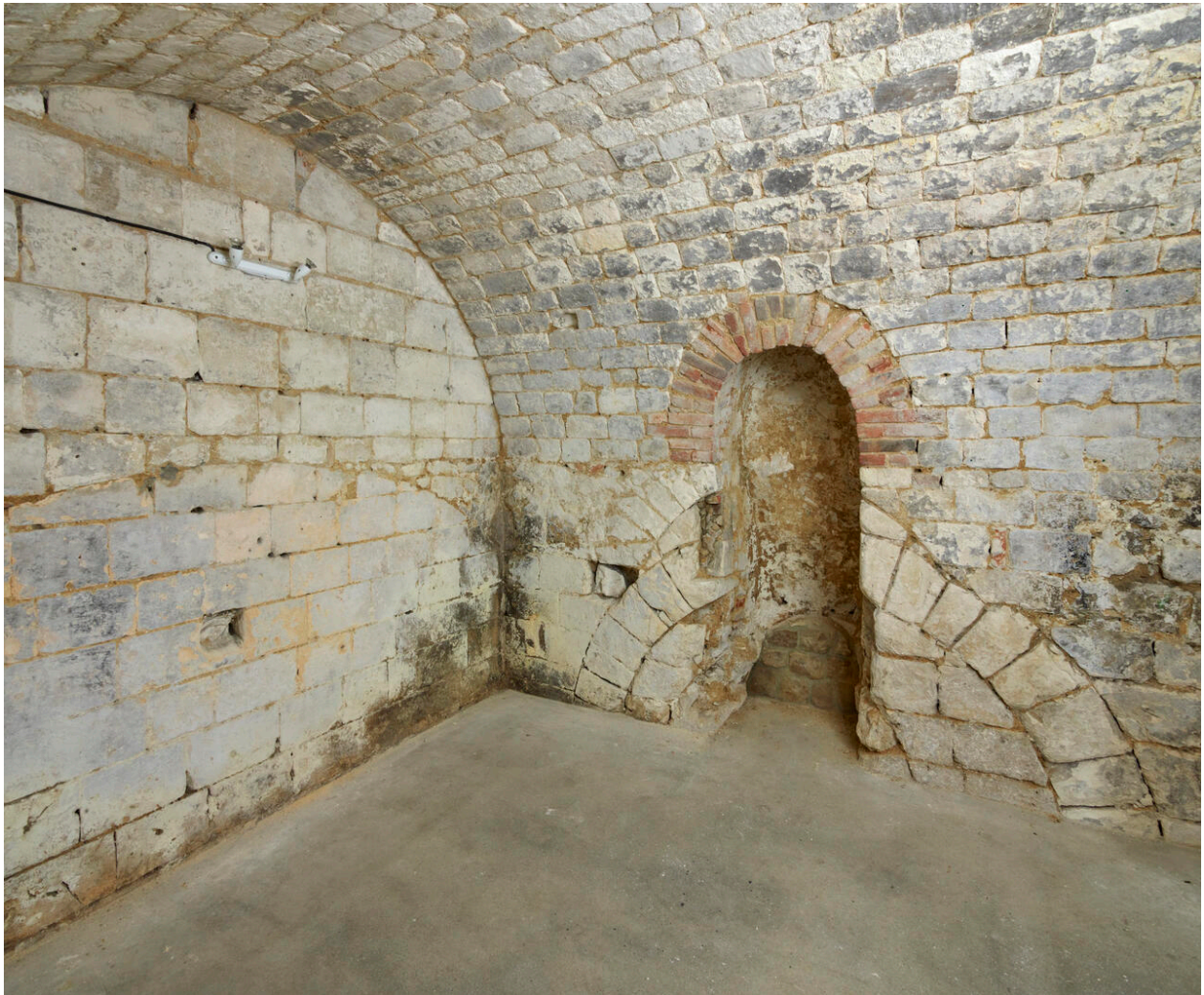
Intérieur de la prison comportant la trace du voûtement de l'ancienne cuve de basse-fosse.
