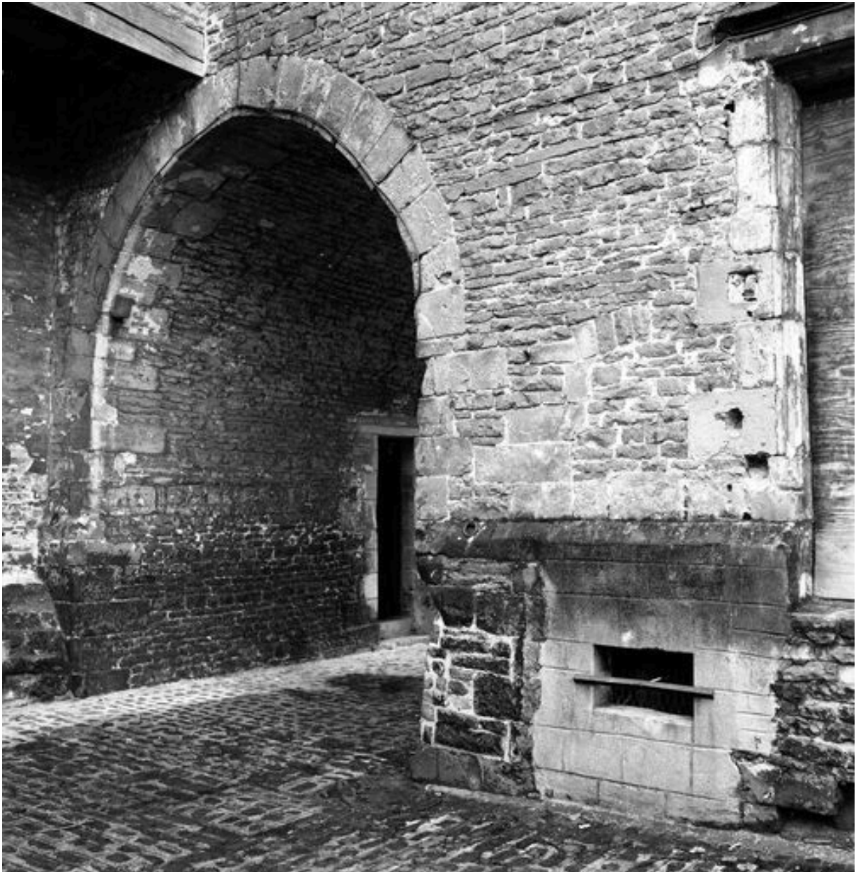
Corps de logis médiéval, façade arrière, rez-de-chaussée, vue partielle : débouché du passage couvert et, au premier plan, emplacement de l'accès d'origine à la cave.
