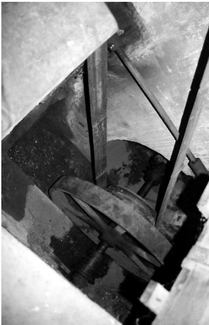
Détail de la première transmission à la sortie de la turbine.
