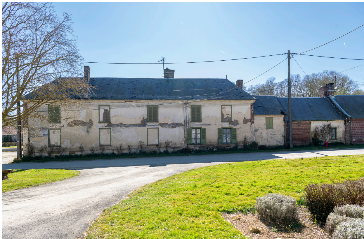
Logis de ferme, n°38 de la rue Principale, vue depuis le nord.
