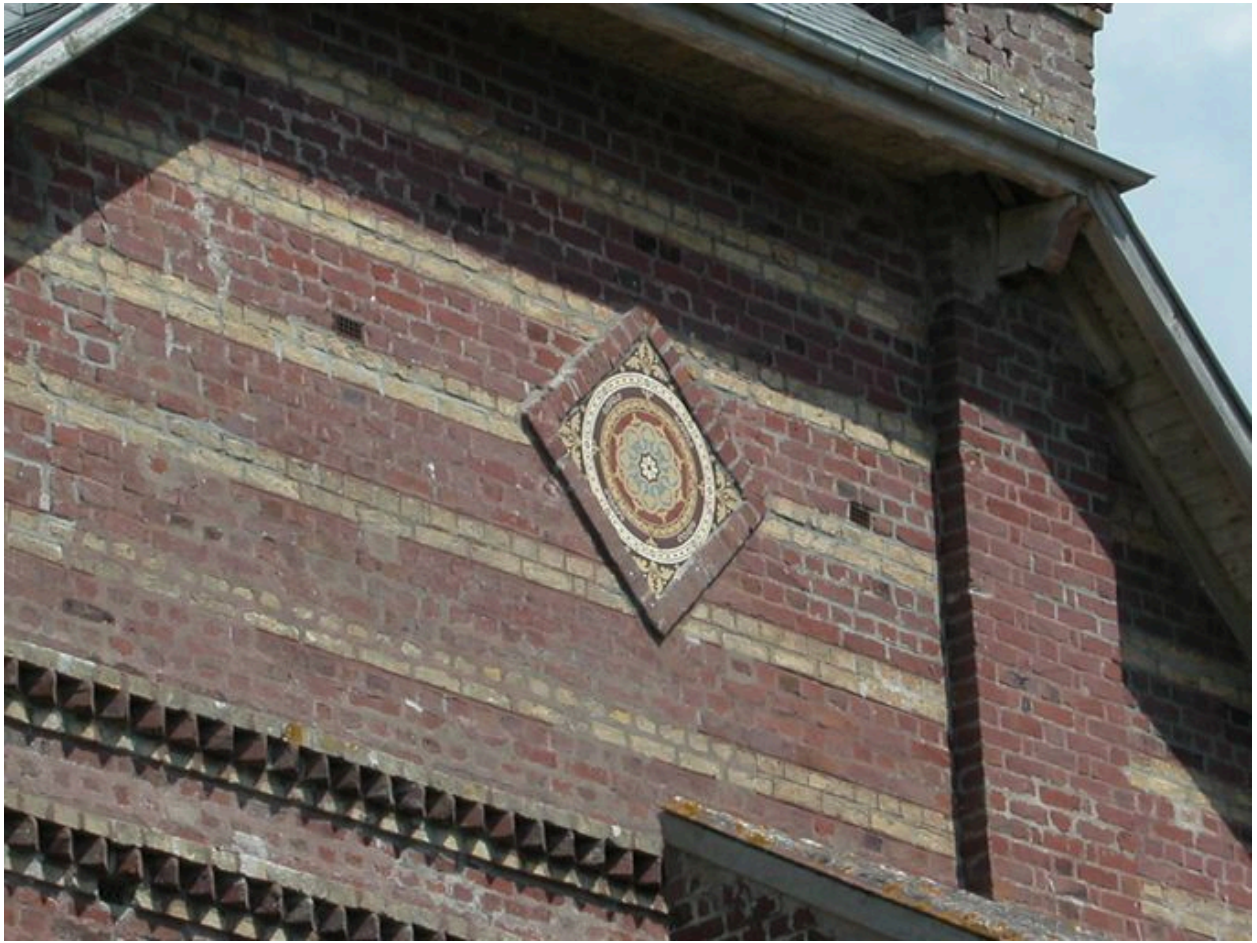
Détail du décor de céramique sur l'élévation latérale droite.
