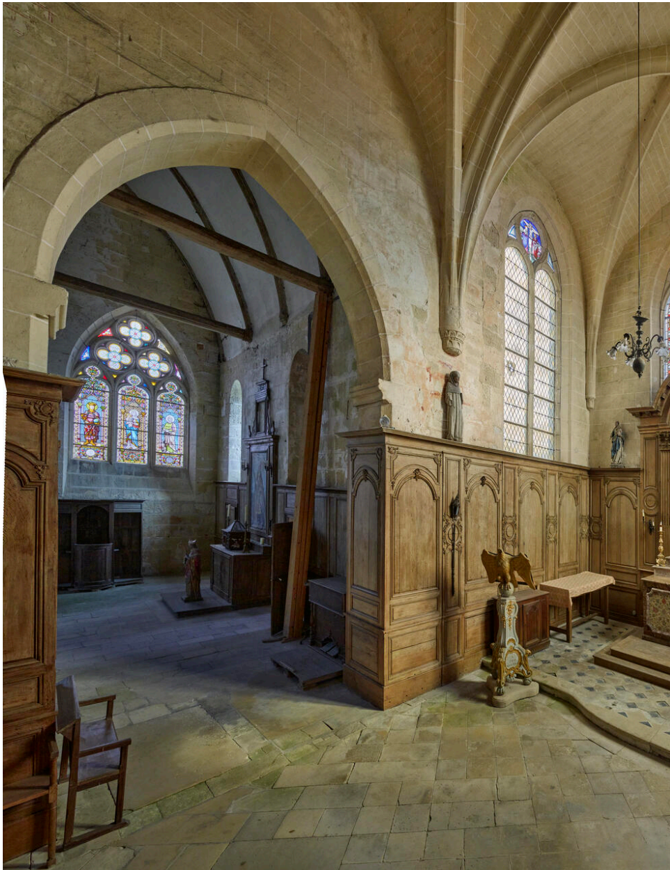
Vue depuis la croisée du transept vers le bras sud du transept.
