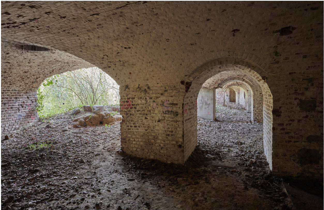
Aile est. Embrasures de tir dans le mur de masque, en partie effondré.
